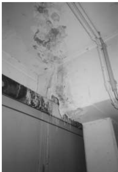
Wasser und Kalk zerstören die Bausubstanz und blockieren das Feuerschutztor
